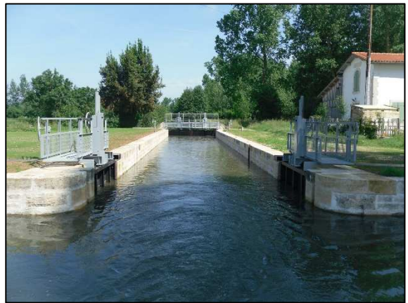
Écluse du Marais Pin - portes amont ouvertes - IIBSN
